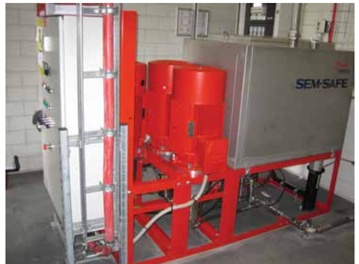
Unité de pompes SEM-SAFE® installée sur Equinix AM3.
